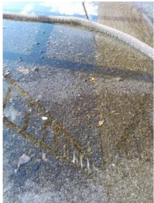
Photos avant nettoyage
