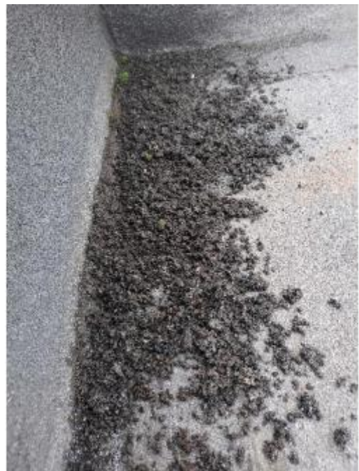
Photos avant nettoyage
