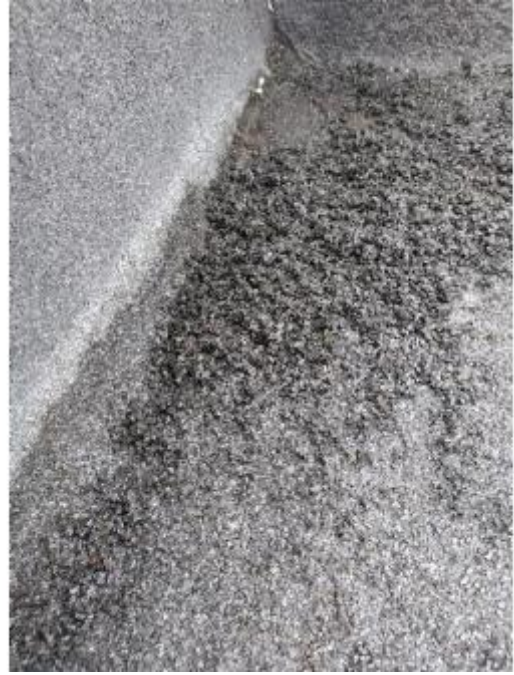
Photos avant nettoyage
