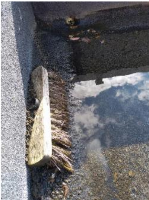
Photos avant nettoyage
