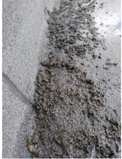
Photos avant nettoyage
