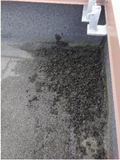
Photos avant nettoyage
