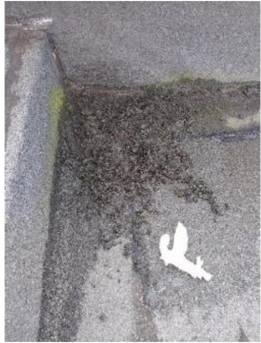
Photos avant nettoyage
