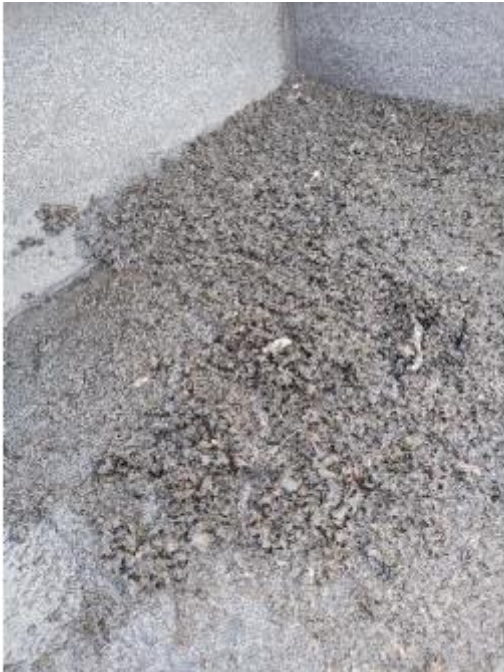
Photos avant nettoyage
