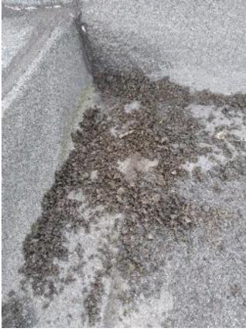
Photos avant nettoyage
