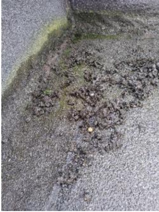
Photos avant nettoyage
