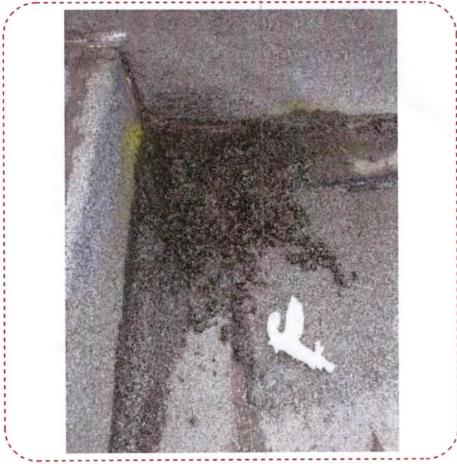
Photos avant nettoyage
