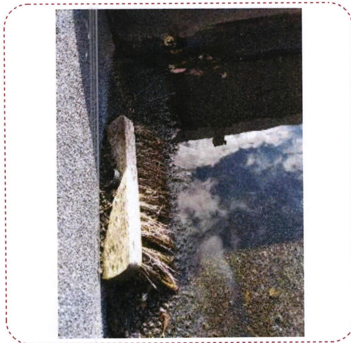
Photos avant nettoyage
