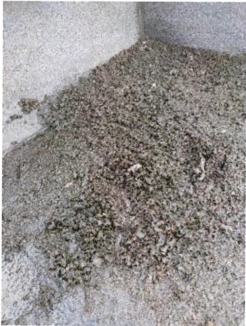
Photos avant nettoyage
