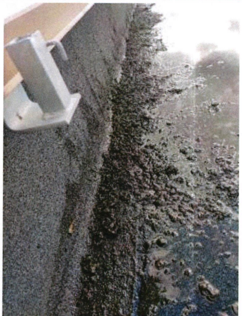
Photos avant nettoyage
