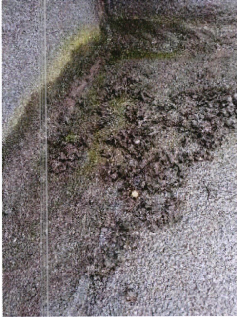
Photos avant nettoyage
