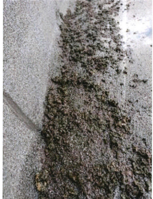
Photos avant nettoyage
