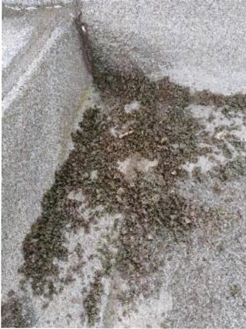
Photos avant nettoyage
