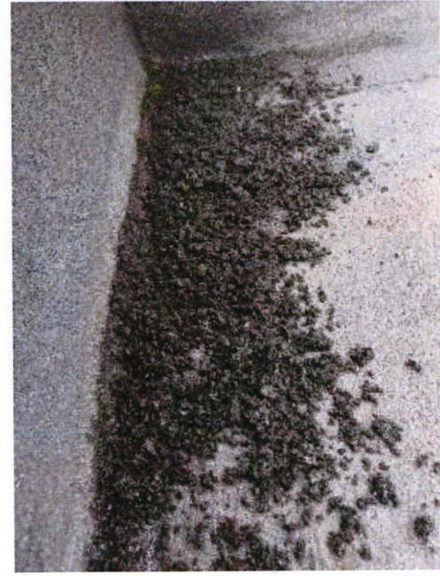
Photos avant nettoyage
