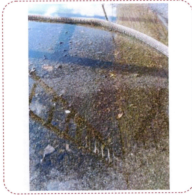
Photos avant nettoyage
