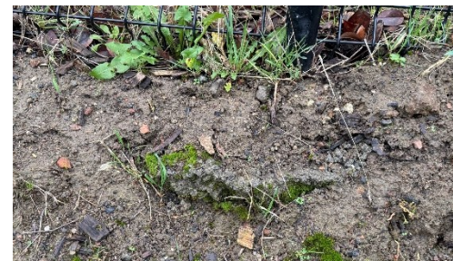
La stabilité de la clôture pourrait être compromise...
