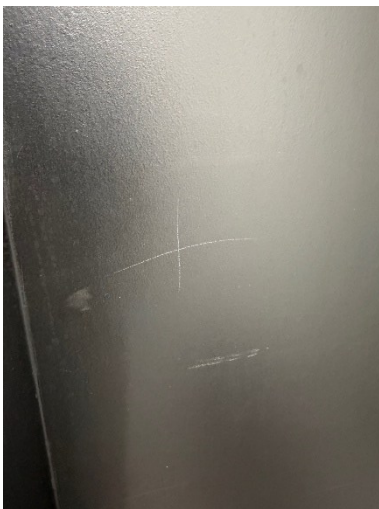
Porte ascenseur au sous-sol
