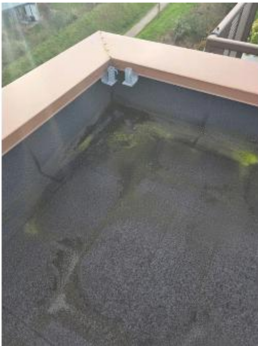
Photos avant nettoyage
