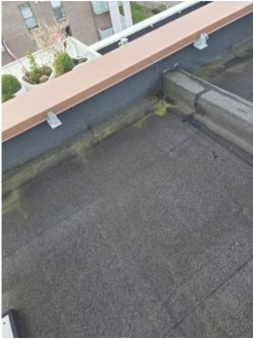
Photos avant nettoyage
