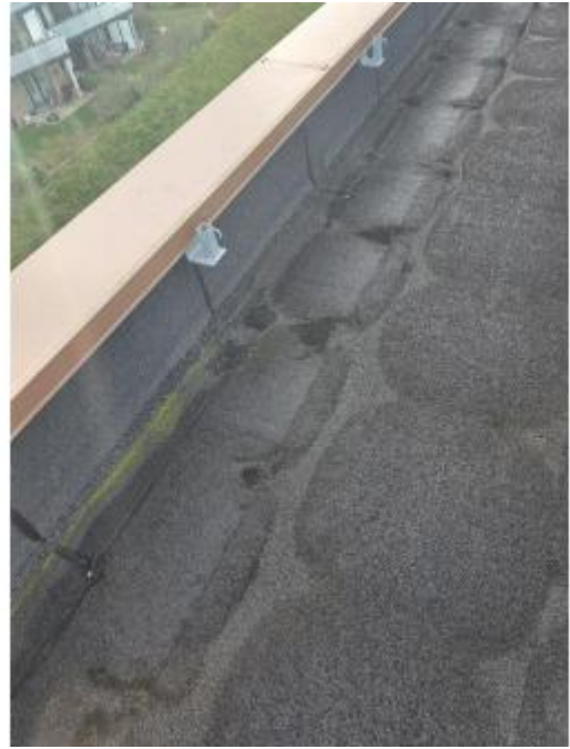
Photos avant nettoyage
