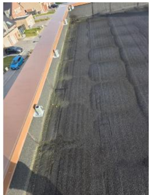
Photos avant nettoyage
