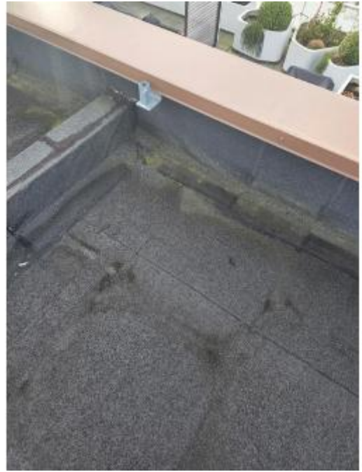
Photos avant nettoyage
