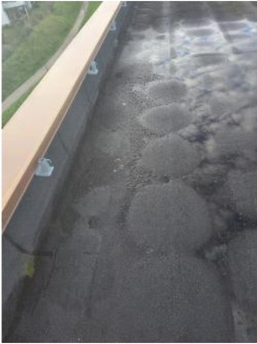
Photos avant nettoyage
