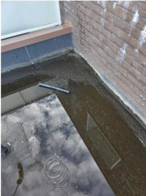
Photos avant nettoyage
