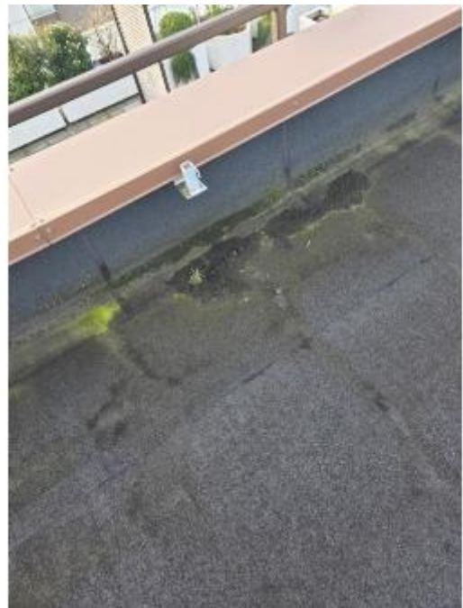
Photos avant nettoyage
