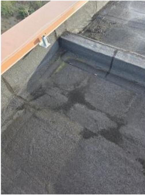
Photos avant nettoyage
