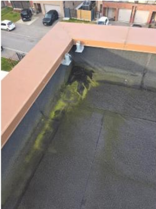
Photos avant nettoyage
