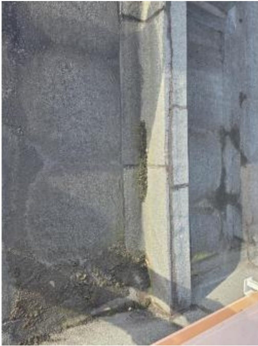
Photos avant nettoyage
