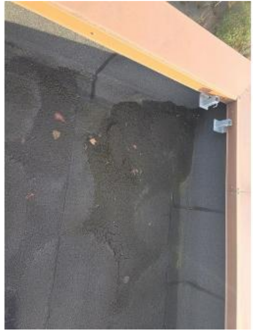
Photos avant nettoyage
