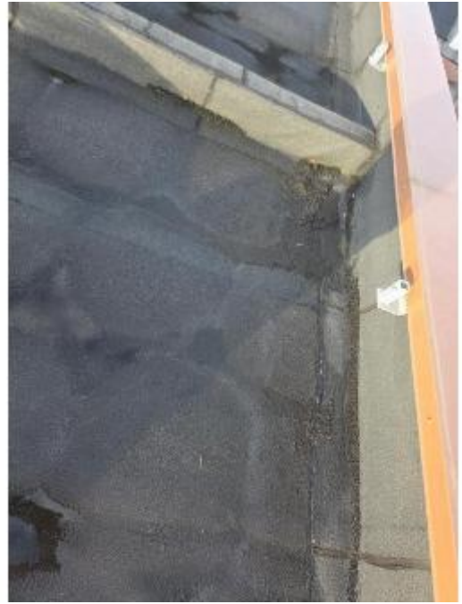
Photos avant nettoyage
